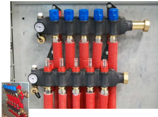
1A) Trubky zpátečky jsou vedené za rozdělovačem přívodní topné vody
